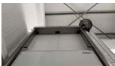
Detalle tercer cable de seguridad
