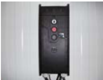
Cuadro de control de puerta rápida frigorífica.
